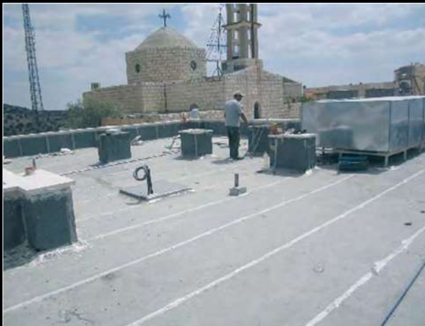
Ad Al-Hashimi e Al-Rusaifeh sono stati effettuati importanti restauri dei presbiteri (foto in alto e al centro) mentre ad Al-Wahadneh ne è stato costruito uno nuovo. Qui i lavori (in basso) sono ancora in corso sul tetto.
